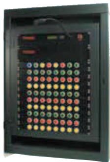
Emergency Panel mit EP EMP
